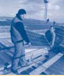
Photovoltaik-Anlage auf dem Dach der heutigen Schüco-Arena
